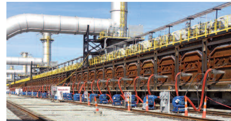
Comienzo de batería de coque para recuperación de calor
